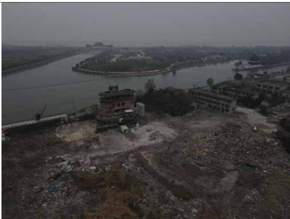
地块东南角部分构筑物未拆除，地块南侧存在部分矿渣和建筑垃圾
